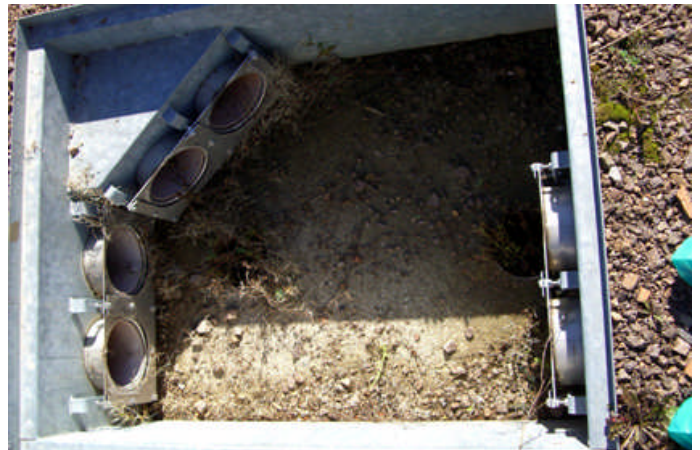
Mynd 47. Tengibox til að tengja saman fiskflutnings rör (Ljósmynd: Jóhann Geirsson).
