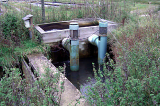
Mynd 24. Vatnsinntak. Vatninu er lyft tæpan metra með dælum (Ljósmynd: Jóhann Geirsson).
